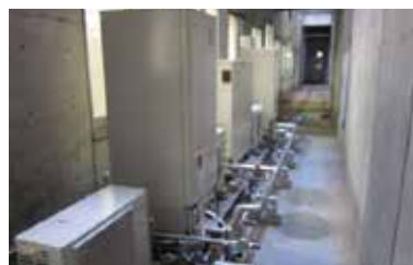
総合研究棟に設置されているHPWH
