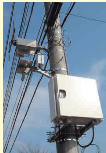
電柱に設置した実証実験装置(写真2)
